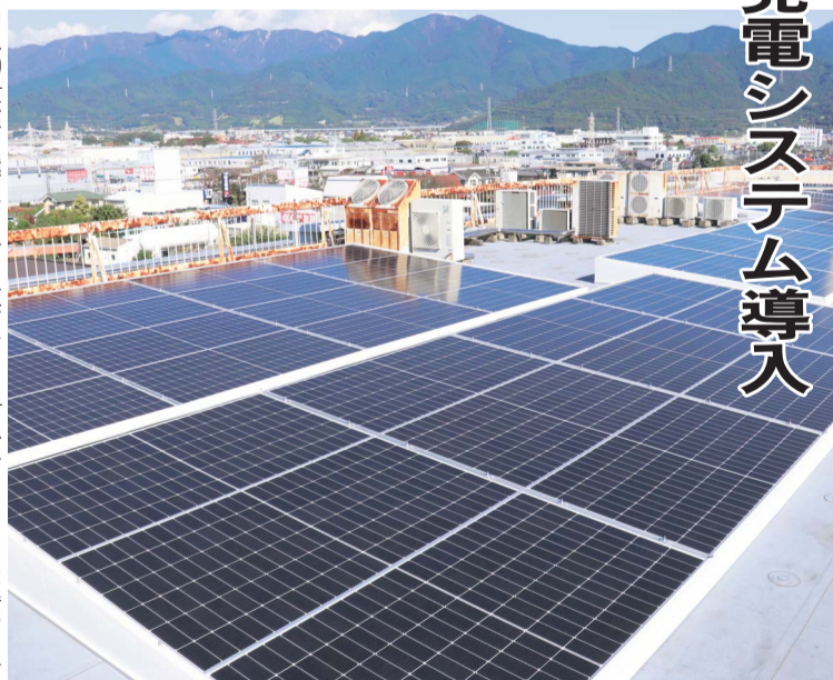
本所屋上に設置した太陽光パネル
